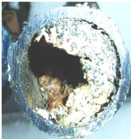
Рисунок 2 – Отложения внутри трубы (по В.А. Медведскому)
